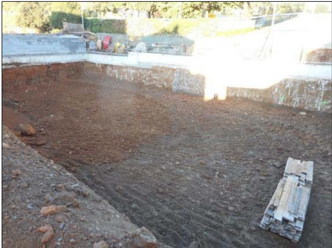
28. Treballs d'extracció de terres del solar en la segona fase, orientació nord.
