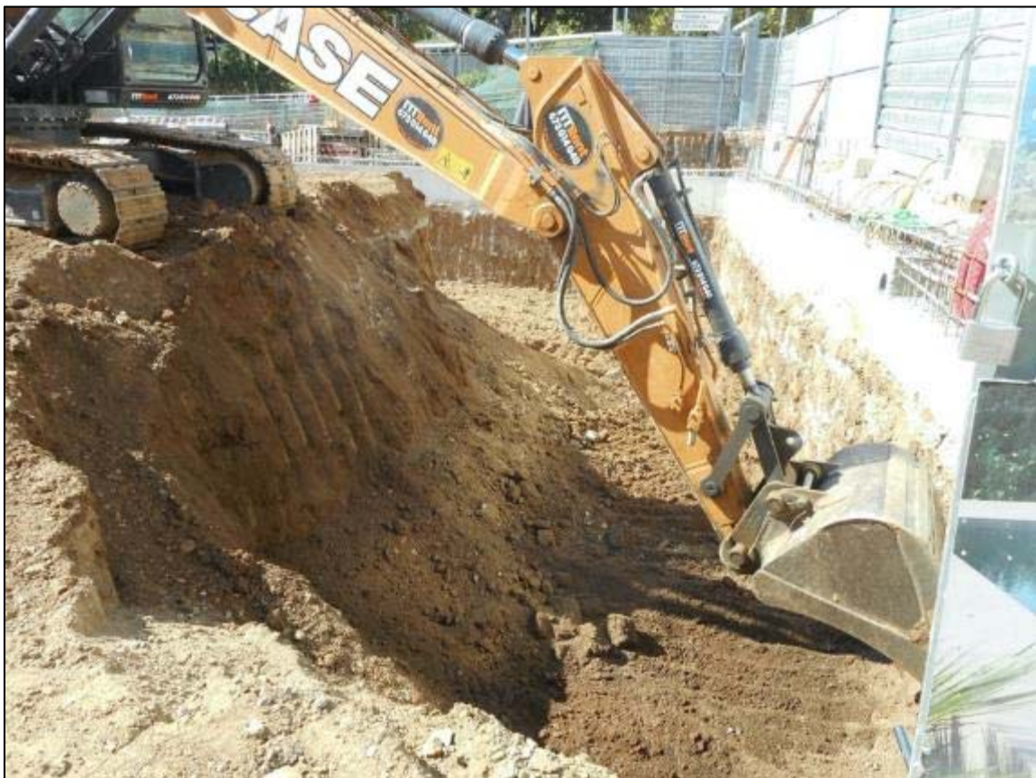
26. Treballs d'extracció de terres del solar en la segona fase, orientació nord.
