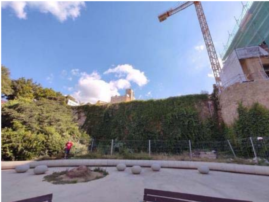
Vista del mur de contenció (UE107) des de la part inferior, des del Parc de Joan Raventós (Foto: Òscar Matas).
